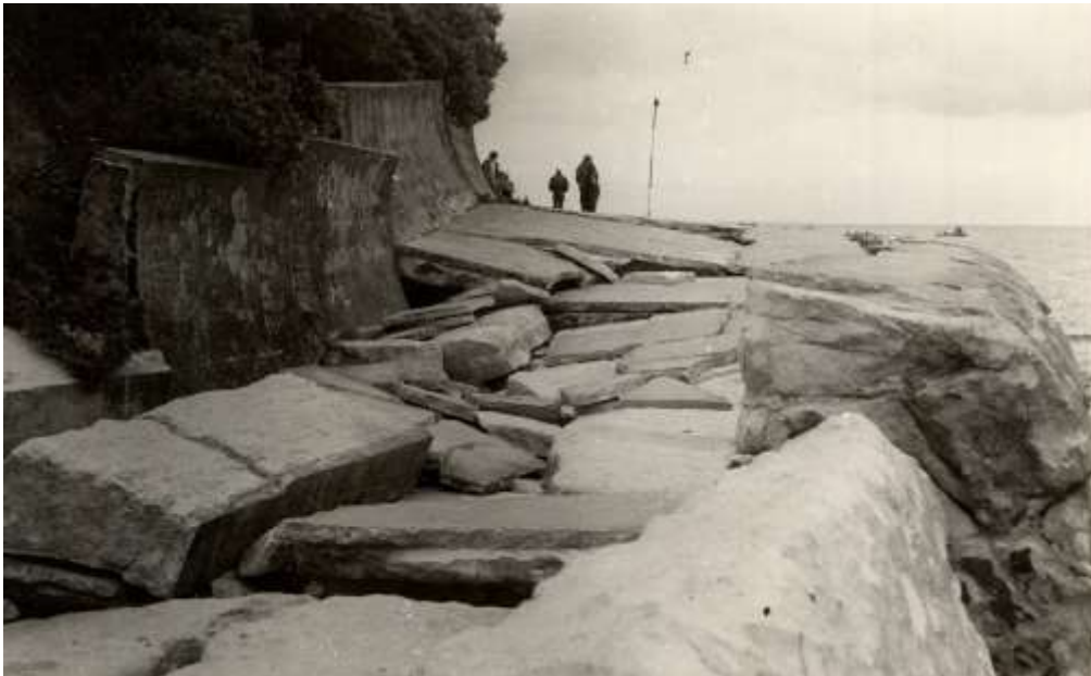
Abb. 35: Eingestürztes Deckwerk der Mauer am Streckelsberg auf der Insel Usedom im August 1959 (aus TIMM, 1960).
