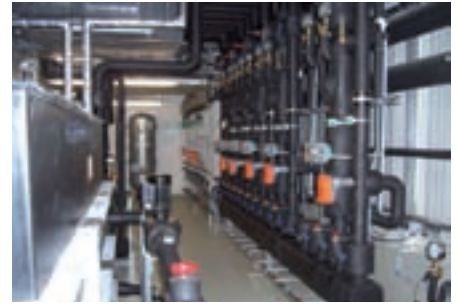
Heiz- bzw. Kühlverteiler
